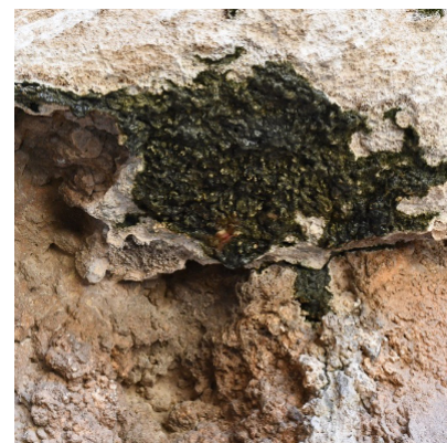
Fig.5 : eau d'égouttage à la grotte de Khatak. Photo LBQ
