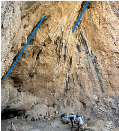
Fig.4 : vue des fractures depuis le porche. Photo LBQ
