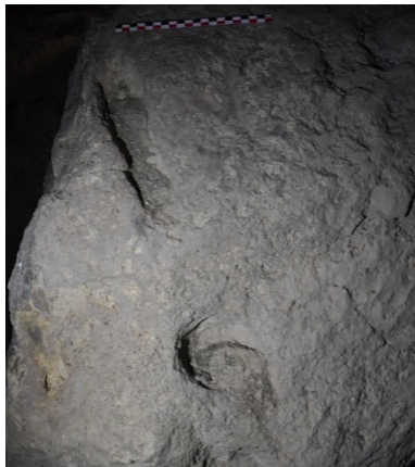
Fig.24 : tine et chenal liés à la biocorrosion par du guano de chauve-souris. Photo LBQ
