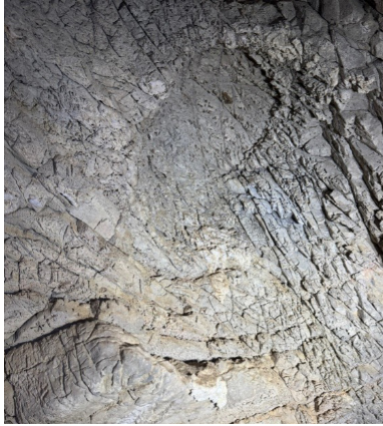
Fig.16 : coupole engendrées par la biocorrosion. On remarque des figures faisant penser à de l'éléphant skin. Photo LBQ
